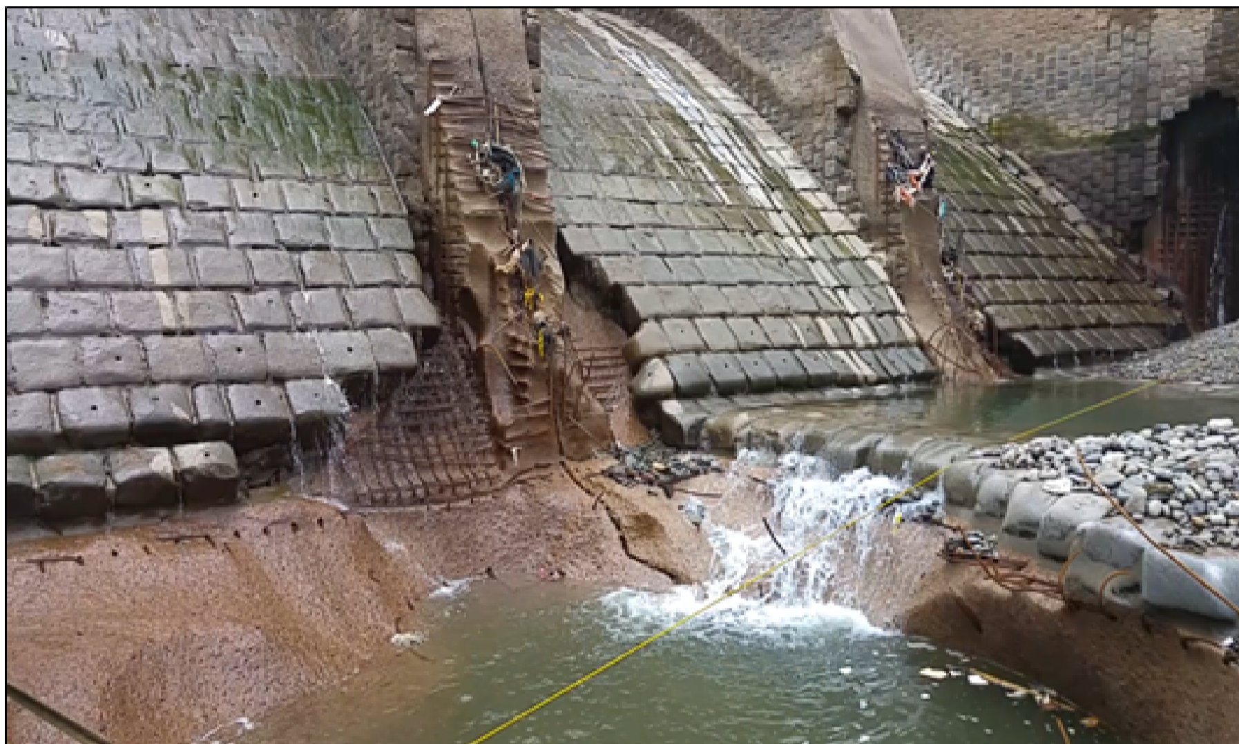
Daños en la Bocatoma de la planta de agua potable de Huachipa
